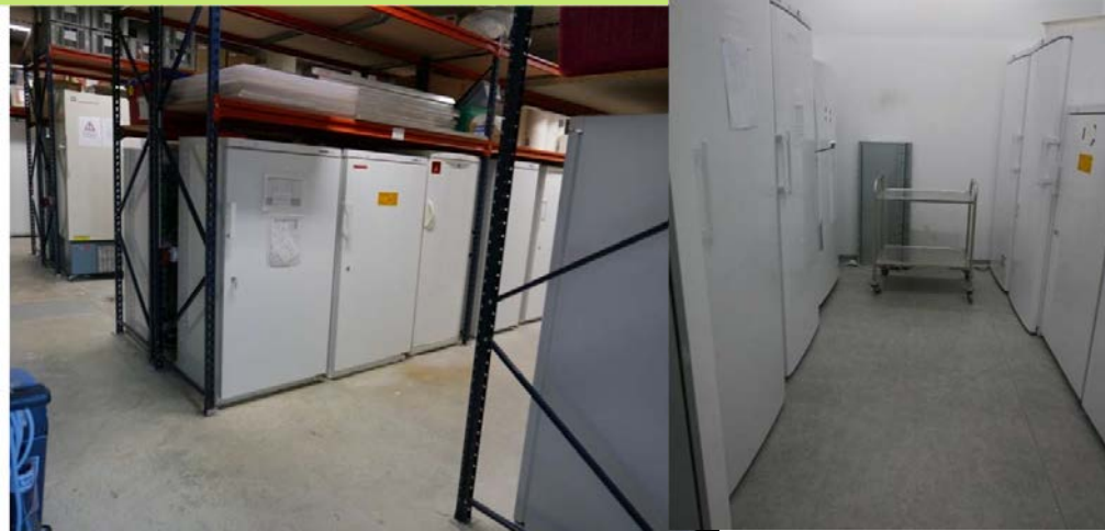
Salles des congélateurs-réfrigérateurs : 8 + 56m 2 , 18-23°C (47 congélateurs, 25 réfrigérateurs)
